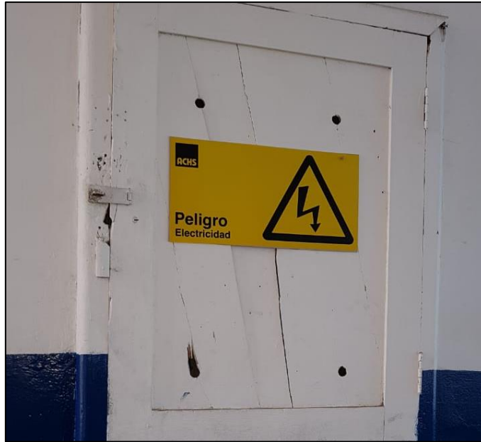
Figura 3.25 Instalación antigua, desenergizada.
