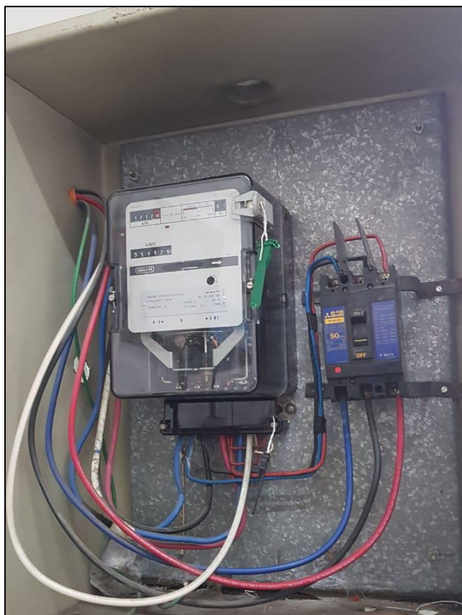
Figura 3.1 Medidor trifásico protección de 50 [A], alimentador 4x8 AWG.
