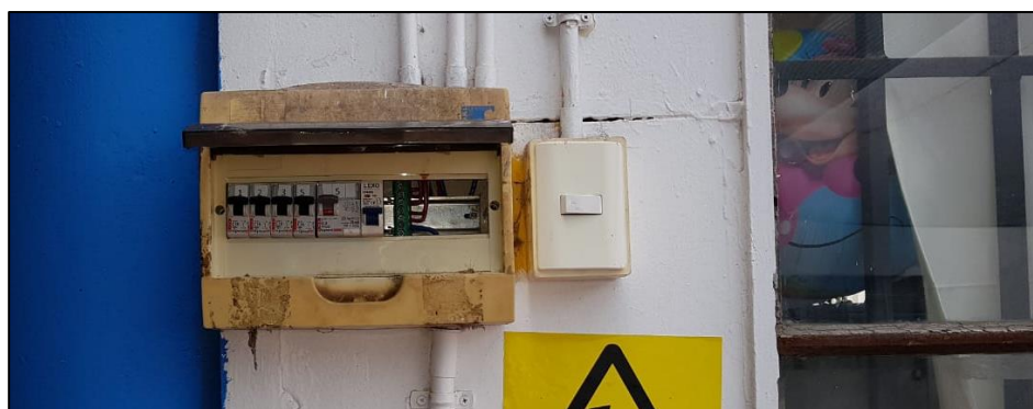
Figura 3.12 TDA 9 segundo piso, condición subestandar, requiere limpieza y mantención, no cumple con el 25% libre.
