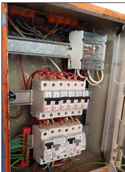
Figura 3.10 TDA 7 segundo piso, condición subestandar, libre acceso, requiere mantención, no cumple con espacio libre del 25%.
