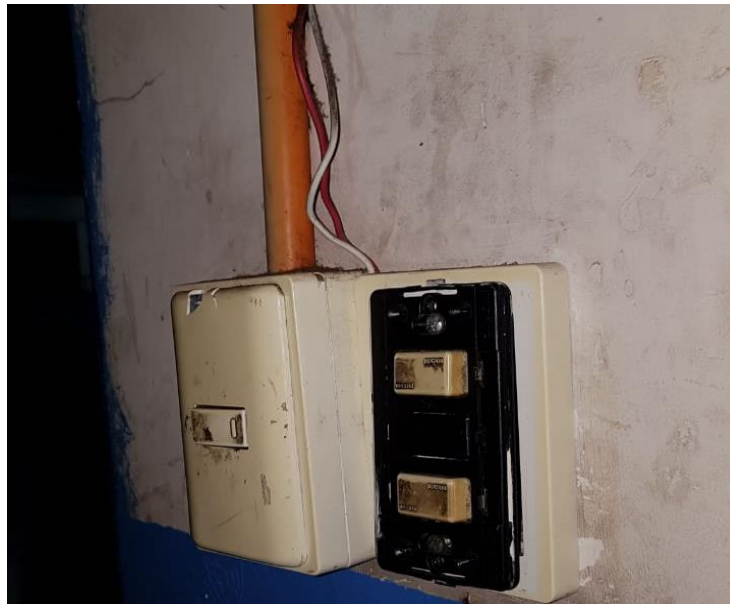
Figura 3.19 interruptor puenteado sin canalización para iluminación sector subterráneo.
