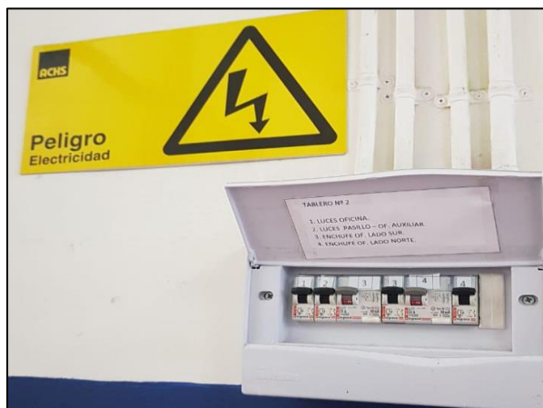
Figura 3.5 TDA 2 primer piso, condición subestandar, sin barra neutro, no cumple punto 6.2.1 NCH Elec 4/2003.
